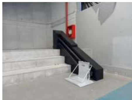
Figura 52. Instalación Salvaescalera Coliseo
