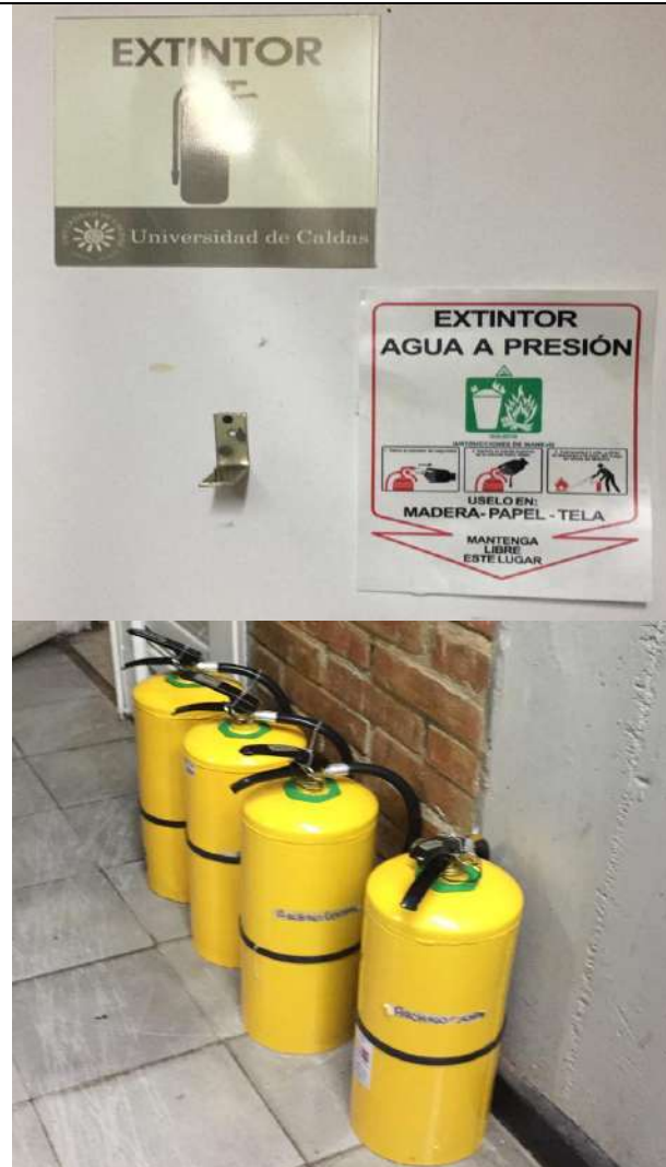
Ilustración 24. Extintor Clase A
